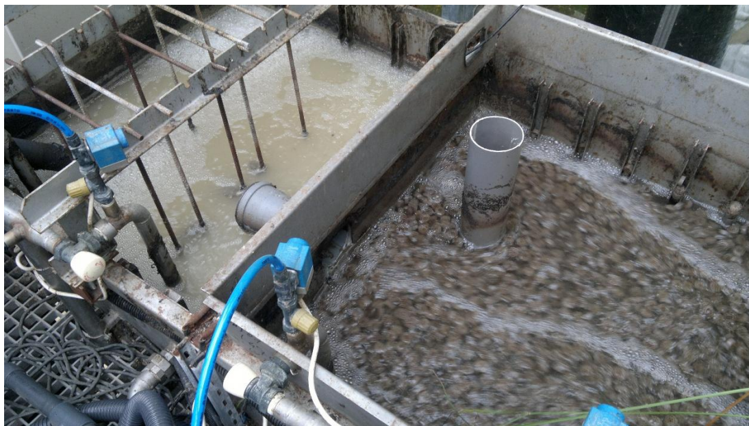
3.1. ábra: Oxigénbevitt lerontó és zavarosságot okozó szerves anyagok jelenléte egy nagyterhelésű szelektorbán (saját fotó [71] alapján)
