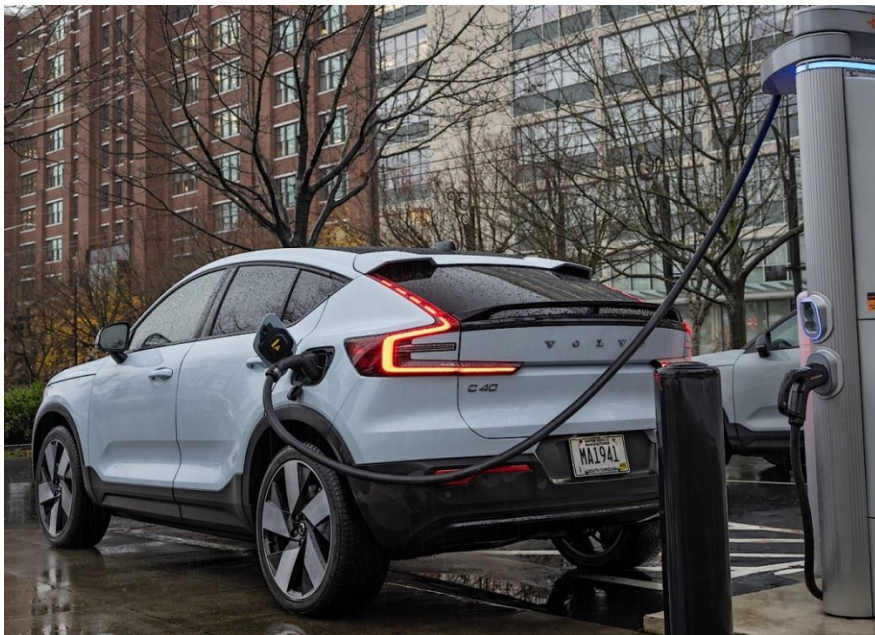
31. ábra Jármű töltése és EVSE csatlakoztatása [327]
