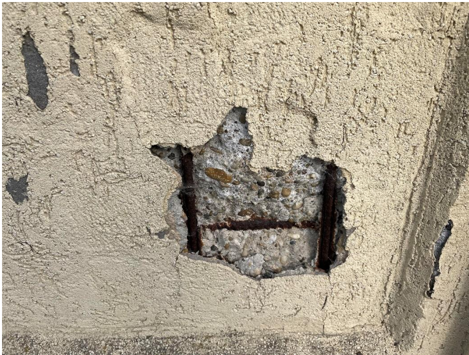
34. ábra Szolnoki parapetfal helytelen betonfedése (készítette: a szerző)
