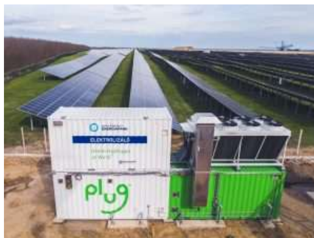
55. ábra A Bükkábrányi Energiapark napelemei és elektrolizáló berendezése [149]
