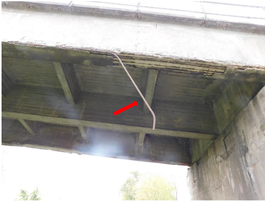
5. ábra: Súlyosan károsodott monolit vasbeton főtartós közúti híd 75
