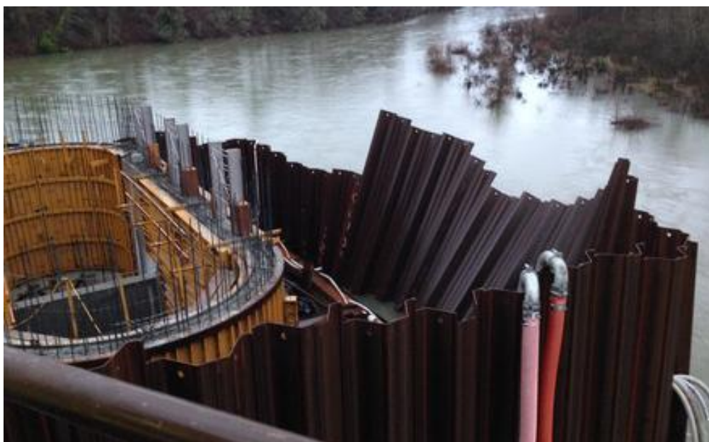
6. kép: Vízáró szádfalas munkatér beomlása [46]
