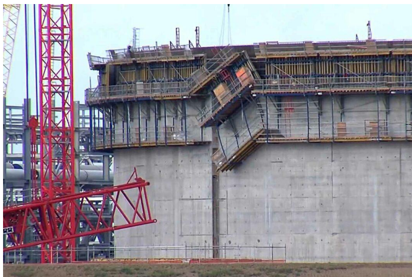
18. kép: Függesztett állvány leszakadása a rossz rögzítés miatt [83]
