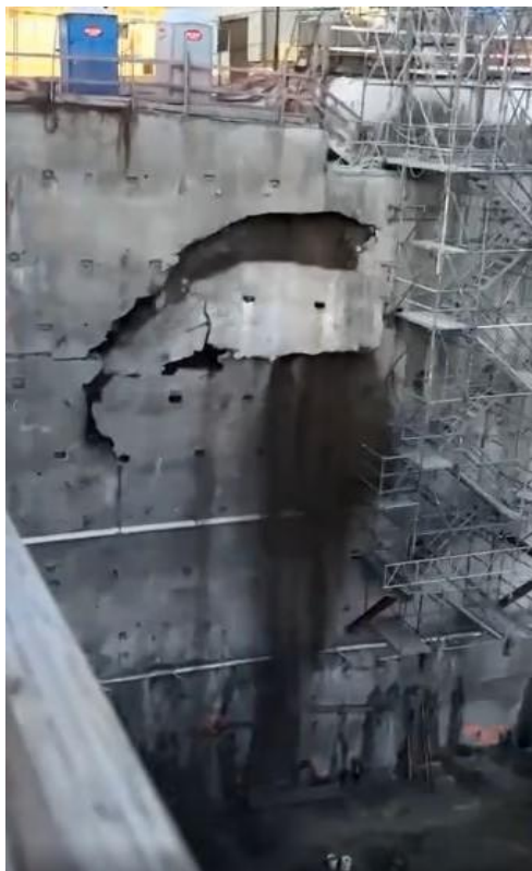
4. kép: Résfal beomlása [43]
