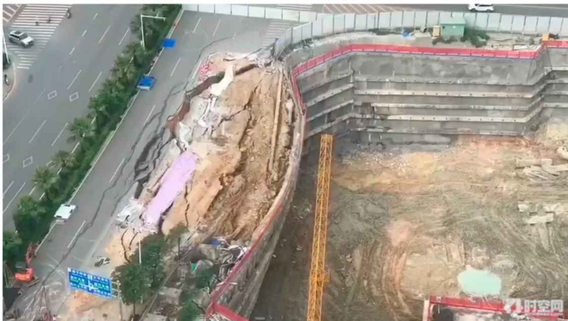
5. kép: Lőtt betonos cölöpfal beomlása [44]
