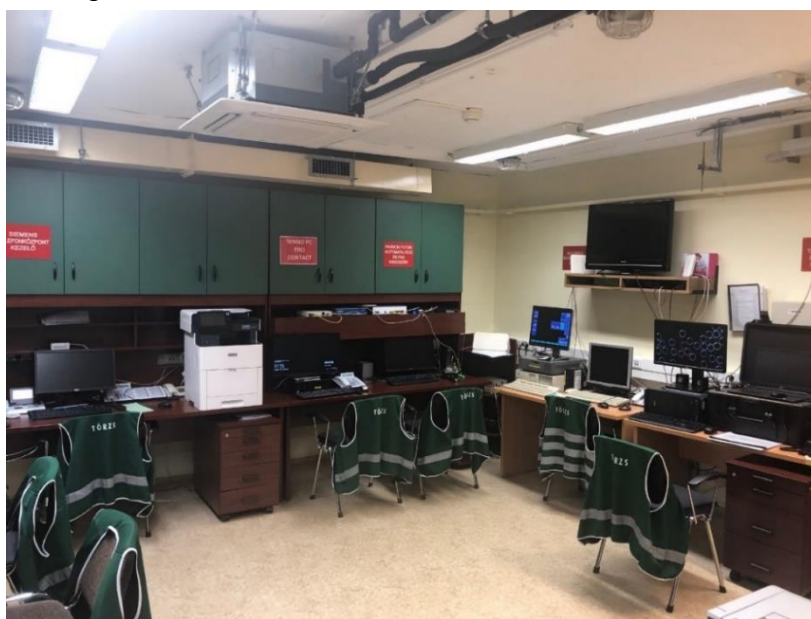
7. kép: Kommunikációért felelős berendezések helysége [saját forrás]
