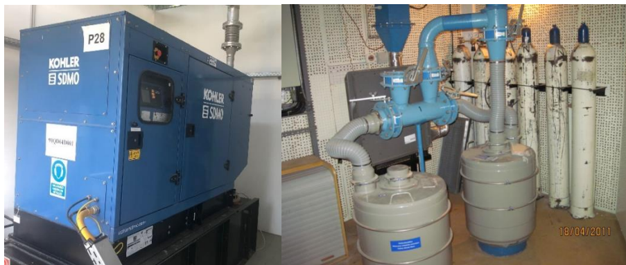
8. kép: Védett Vezetési Pont dízel generátora és hermetizálás esetén a levegőtisztító rendszere [saját forrás]
