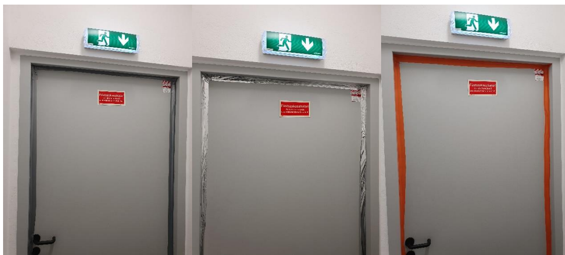
10. kép – szálerősítésű, alumínium és PVC szalaggal lezárt rések, készítette a szerző
