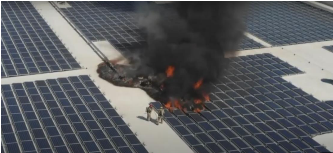
22. ábra. Tűzoltói beavatkozás egy kigyulladt napelemparkban Forrás: [108]
