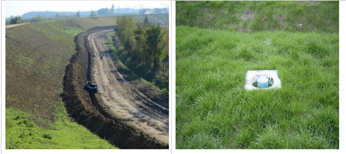
68. ábra A, Drénszivárgó kivitelezése a Fekete-Körös mentett oldali töltéslábánál; B, Nyomáscsökkentő kút a Fehér-Körös mentett oldali előterén (forrás: Körös-vidéki Vízügyi Igazgatóság) (készítette: a szerző)
