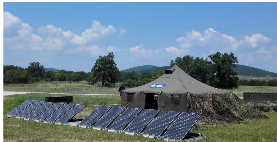
59. ábra: Az IDE napelemei mögött alig látható (bal oldalon) az aggregátort és az akkumulátorokat is tartalmazó központi egység (saját felvétel)
