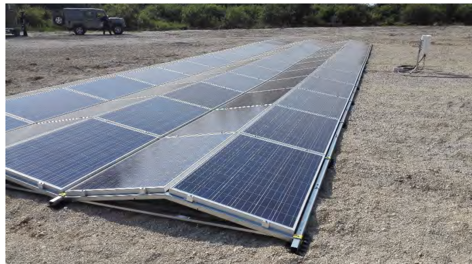
57. ábra: Az EST napelemei telepítve (saját felvétel)
